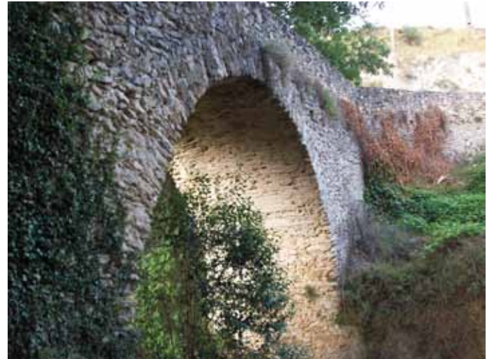
Puente asolado en Alfafara
